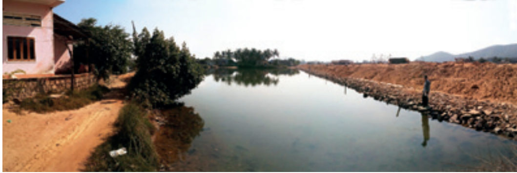
Ảnh 14. Cảnh khu tái định cư (phải) đang xây dựng gần đập tràn số 1.
